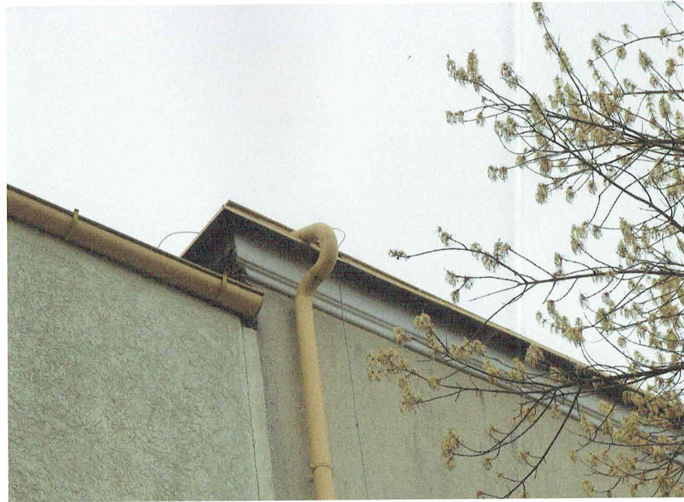
FOTOGRAFIA OBRAZUJE AKTUALNY GZYMS KORONUJĄCY STAREJ CZĘŚCI BUDYNKU DYDAKTYCZNEGO. PLANOWANE ROBOTY BUDOWLANE NIE BĘDĄ NARUSZAŁY ISTNIEJĄCEGO GZYMSU.
